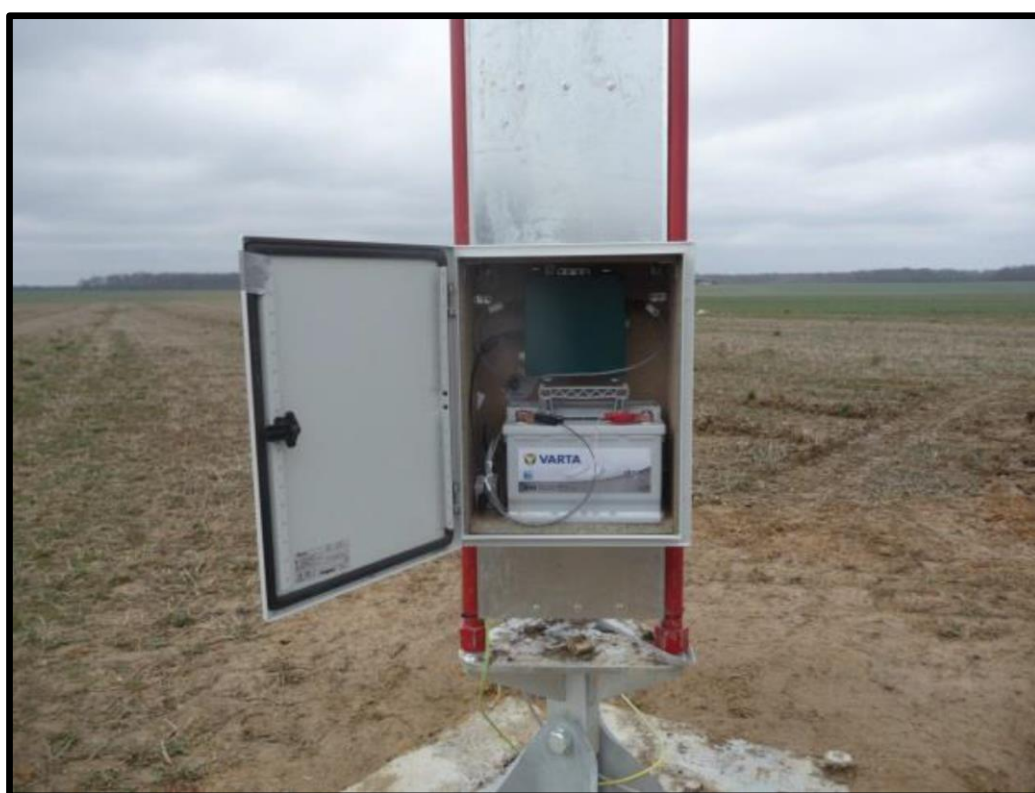
Photo n° 5 : Caisson contenant la batterie et le détecteur SM2.
